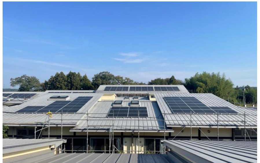
太陽光発電設備の整備を行いました(R5.10月下旬完成)
